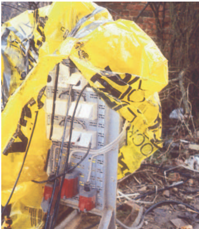
Bild 5: Unzulässiger provisorischer Baustromverteiler
