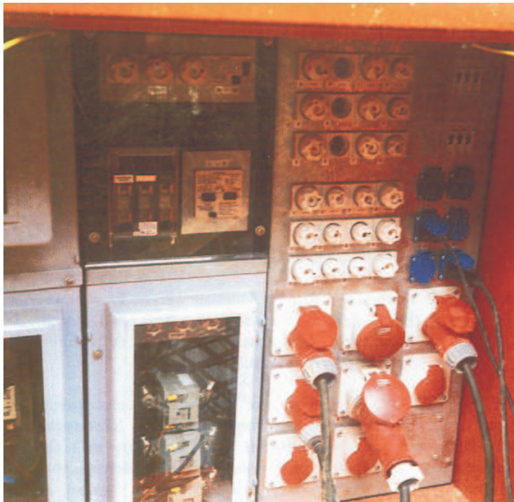
Bild 2: Baustromverteiler mit Sicherheitsmängeln– fehlende Schraubkappen
