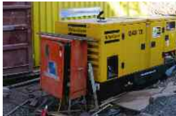
Bild 34 Elektrische Energie erzeugt durch Dieselgeneratoren
