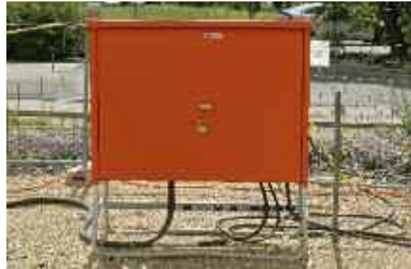
Bild 33 Stromversorgung der Baustelle über abschließbaren Anschlusschrank
