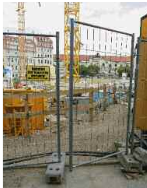
Bild 39 Fußgängertor im Bauzaun
