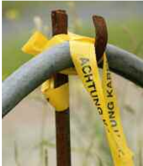
Bild 36 Gesicherte Strom- leitung
