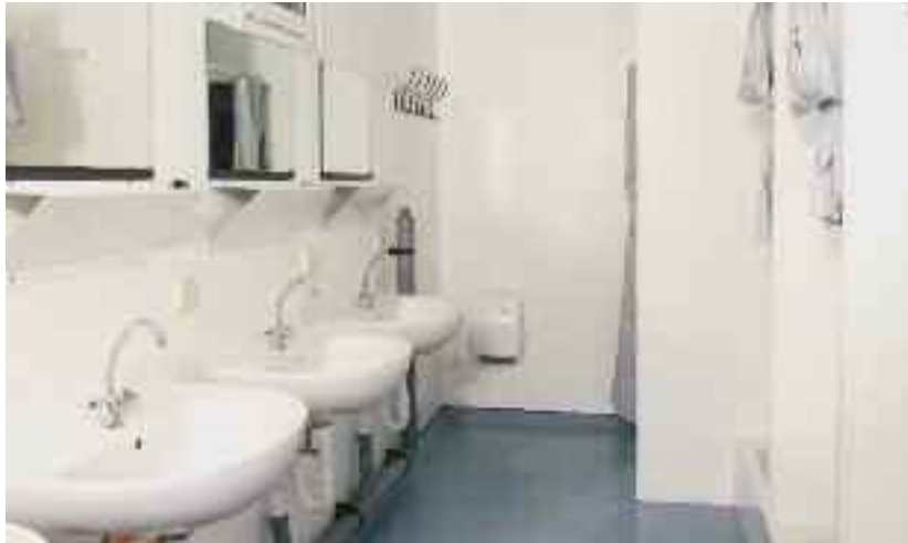
Bild 18 Toilettenzelle als Sanitäranlage
